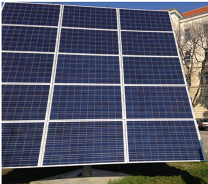
Slika 16: Fotonaponska elektrana Riteh 1
